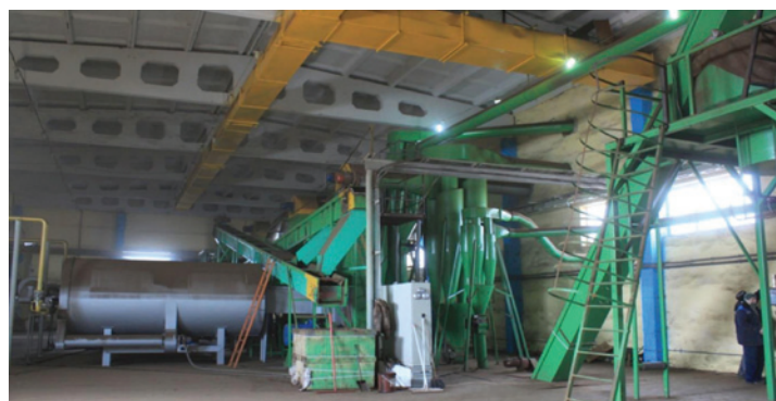
Εικόνα 4: Μερική Άποψη Εγκατεστημένης Μονάδας
